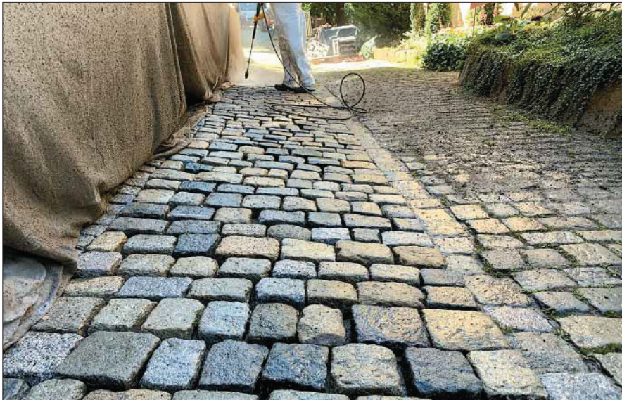
Das Verfahren ist sehr nachhaltig: Die vorhandenen Pflastersteine und der Unterbau bleiben bestehen.
