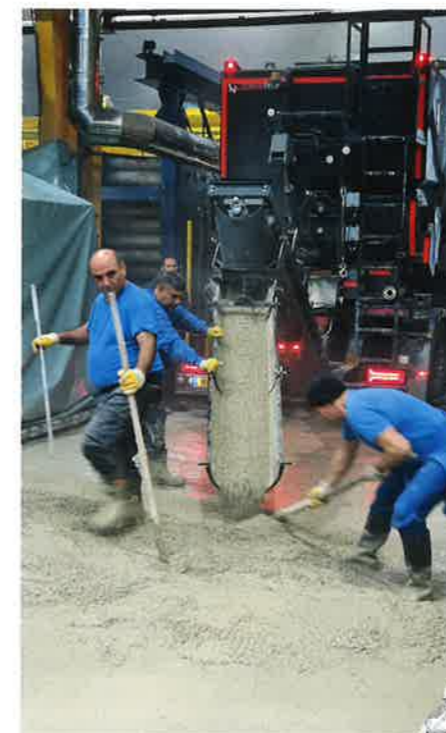
oben Mithilfe der volumetrischen Mischtechnik ließ sich der Beton zügig einbringen (Foto: © Korodur, Amberg)
