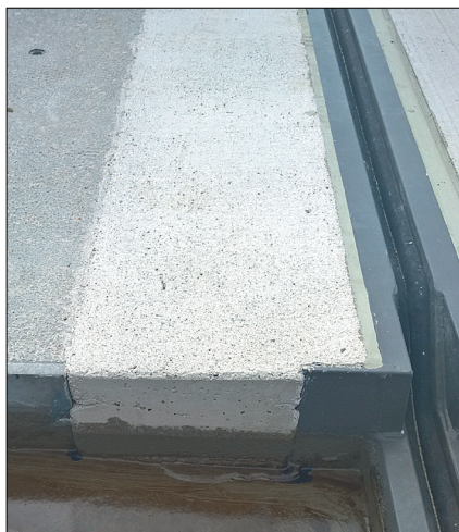
Auch in Außenbereichen wie bei dieser Brückensanierung machen mineralische Alternativen den Einsatz von Epoxidharzen unnötig.
