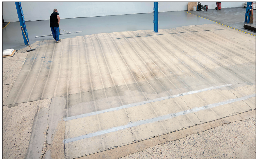
Im ersten Schritt wurden die bei Becker & Lietke zu sanierenden Flächen mit einer Kugelstrahl-Behandlung vorbereitet.
