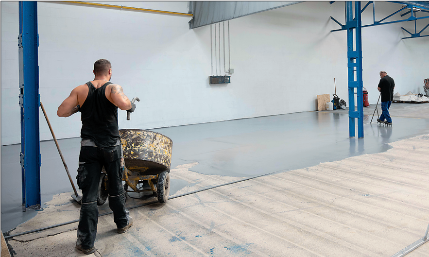
Um eine gleichmäßige Verteilung aller Bestandteile, wie zum Beispiel der Zuschläge, zu gewährleisten, wurde der Magnesit-Estrich nicht mit einer Pumpe, sondern mit einem Zyklonmischer in die passende Konsistenz gebracht und anschließend aufgetragen.
