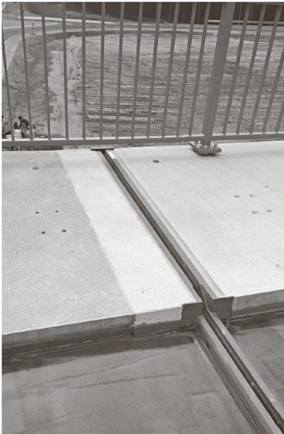
Sicher überbrückt: Bei dieser Instandhaltung für das Widerlager einer Brücke wurde die oberste Tragschicht mit Rapid Set im Nu wiederhergestellt.
